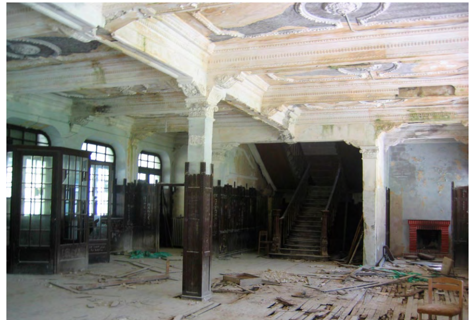
Die Schäden am Gebäude sind enorm. Feuchtigkeit durchdringt die Wände, überall riecht es nach Schimmel. Vandalismus und mangelnde Pflege tun ein Übriges... Fotos: Jürg Suter
