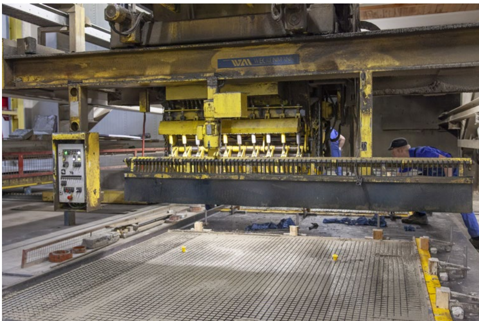
Dank Carbon kommen die Wände mit deutlich weniger Beton aus. Hier zu sehen die Produktion der Wände des Cube an der TU Dresden. Foto: Stefan Gröschel
